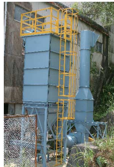
粉塵を集塵する粉塵集塵設備
