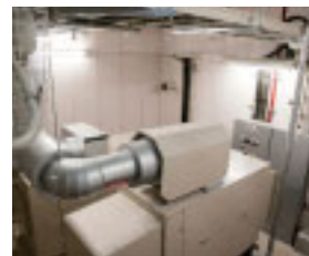
非常用発電装置
