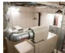
非常用発電装置
