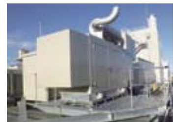
非常用発電装置
