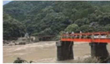
令和2年7月豪雨（熊本豪雨）「深水橋 橋梁喪失」
